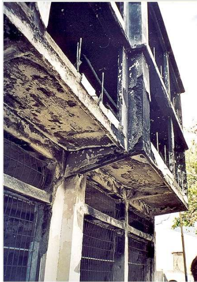
Zerstörtes Haus in Dili
